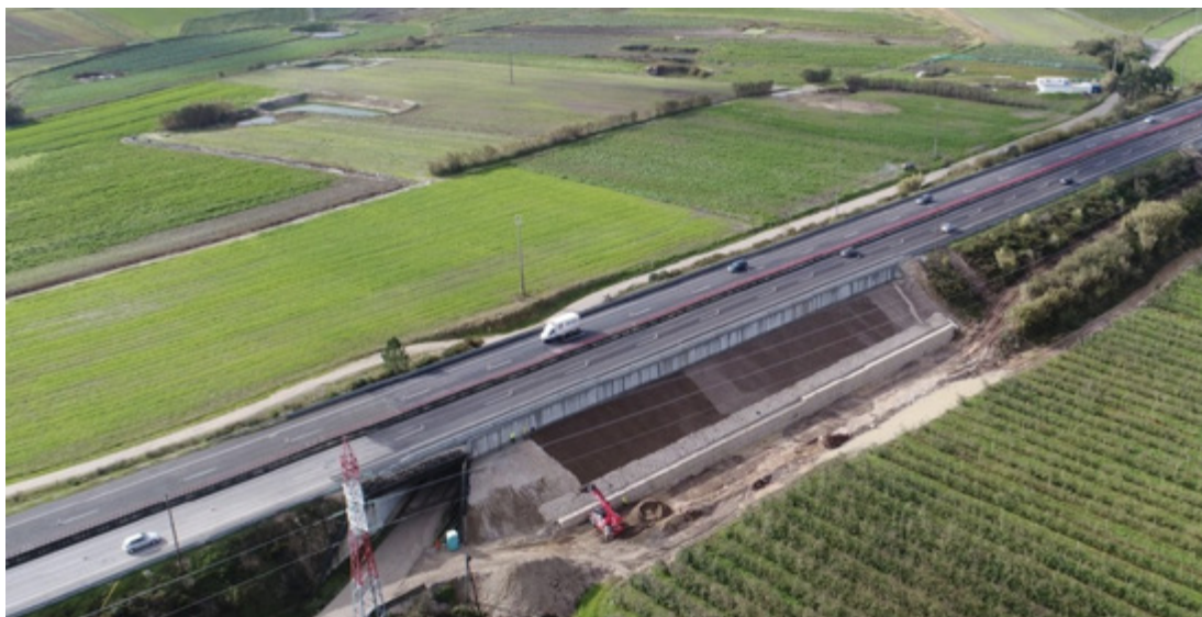
IP6. KM 13+670 E 14+430. ESTABILIZAÇÃO DA PLATAFORMA RODOVIÁRIA (VIADUTO DO OLHO MARINHO) (LE)
